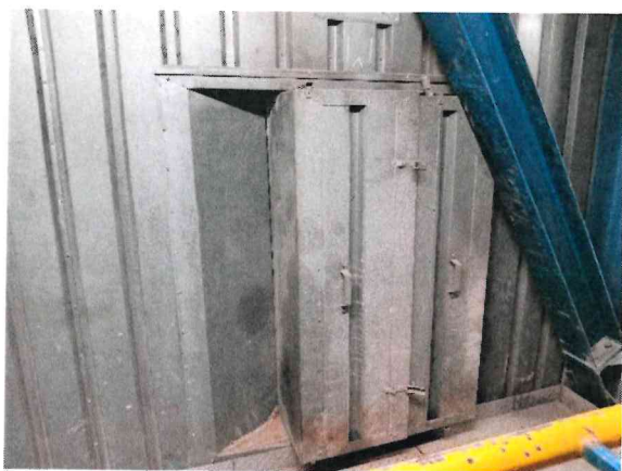
Ľavá strana obratovej komory K2
