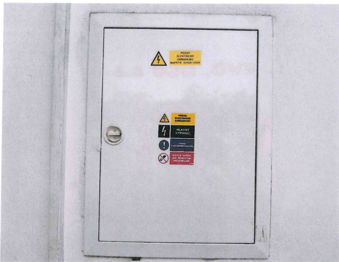
Rozvádzač 3x400/220V umiestnený na vstupe 102
