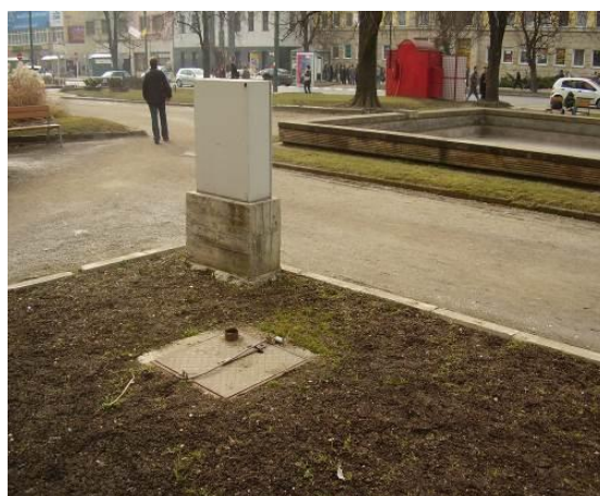
Fontána Divízia - elektrický rozvádzač a šachta
