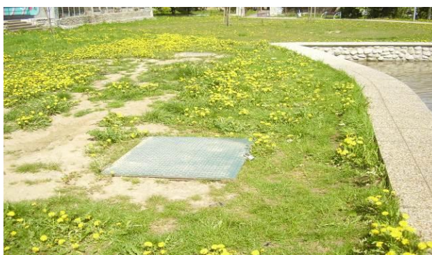
Fontána Družba - technologická šachta
