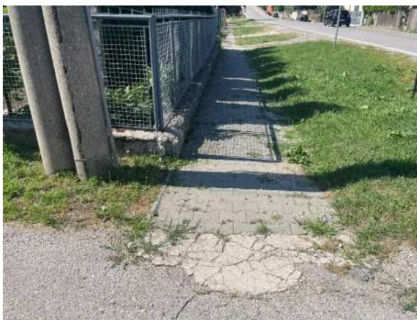
Styk vozovky s chodníkom na ul. Topoľčianska
