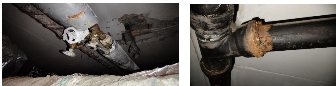
Obrázok č. 10, 11– fotografie porúch v objekte z pohľadu zdravotníckej (vodovod a kanalizácia)
