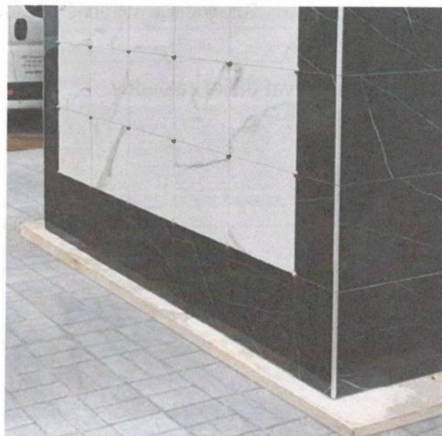
Precízne pripravené základy nepotrebujú následné prekrytie nerovností. Je len na zákazníkovi, či chce betón ponechať pohľadový, alebo vzhľad doplniť prekrytím.
