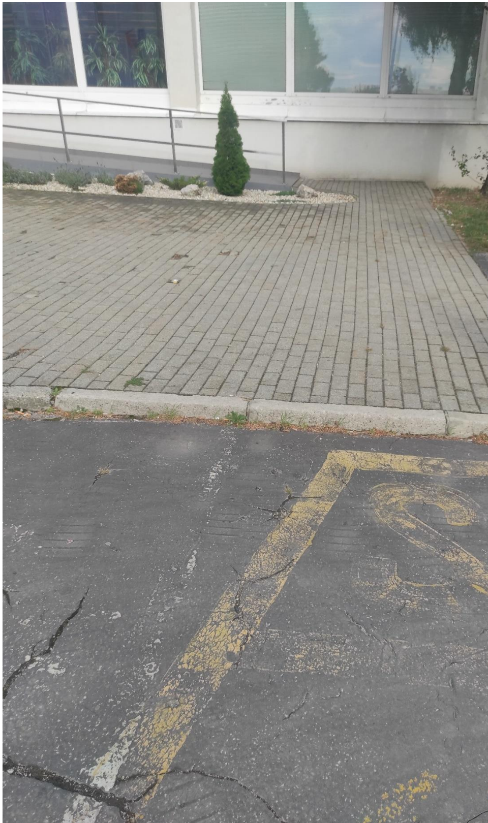
Bariéra - obrubník pri vstupe na rampu do budovy
