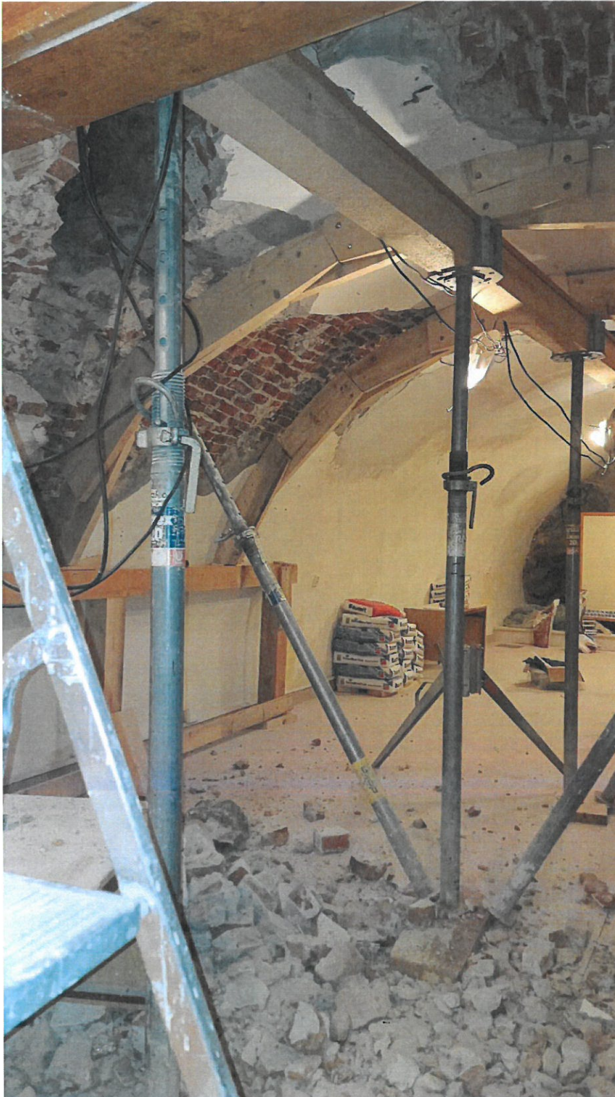
Obr.č. 4 Havarijný stav klenby pivnice, 03. 09. 2021 (foto TAROSI c.c. s.r.o.)
