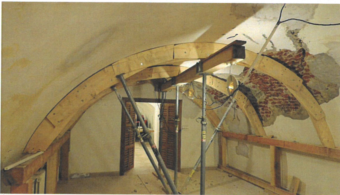
Obr.č. 2 Havarijný stav klenby pivnice, 03. 09. 2021 (foto TAROSI c.c. s.r.o.)
