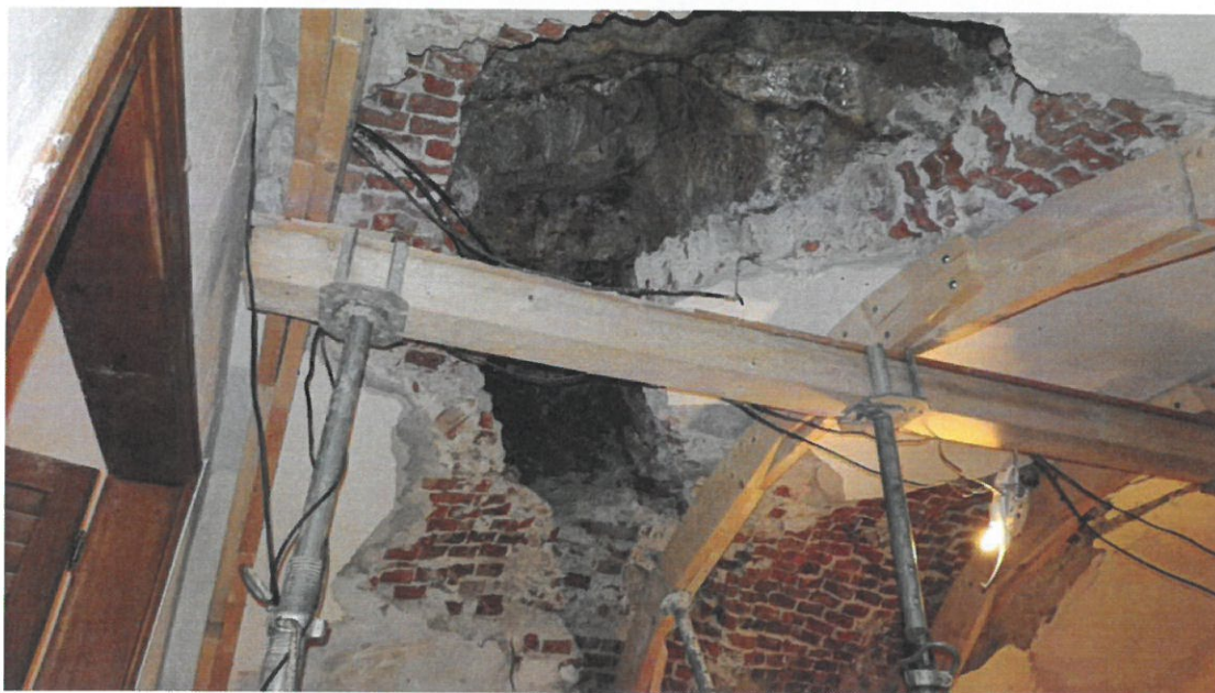
Obr.č. 3 Havarijný stav klenby pivnice, 03. 09. 2021 (foto TAROSI c.c. s.r.o.)
