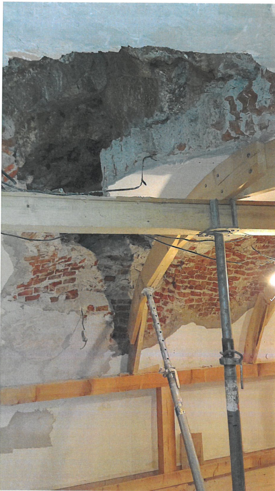
Obr.č. 5 Havarijný stav klenby pivnice, 03. 09. 2021 (foto TAROSI c.c. s.r.o.)
